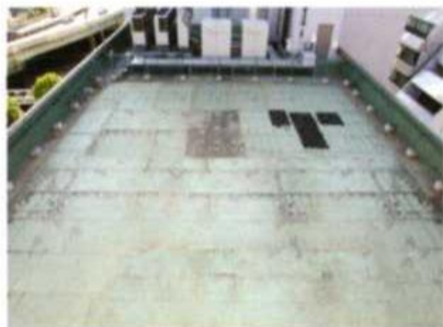
①施工前の“裸の状態”。都会の真ん中にある無機質な空間というイメージ
